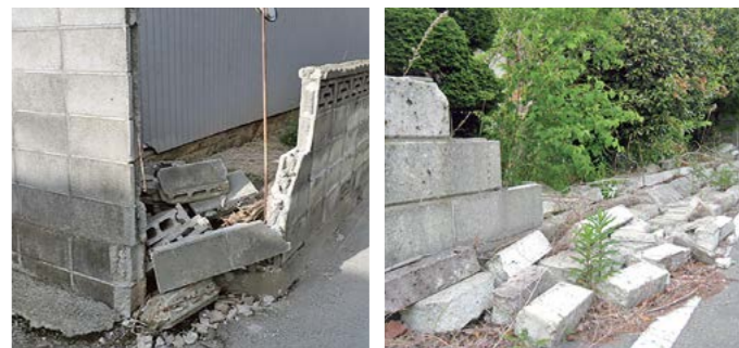
地震で倒壊・損壊したブロック塀(日本建築防災協会パンフレットより)
