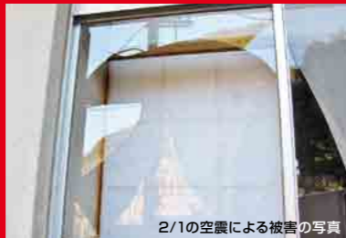
2/1の空襲による被害の写真
