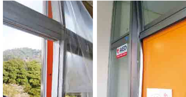
2月1日の空震で折れ曲がったサッシとドア
