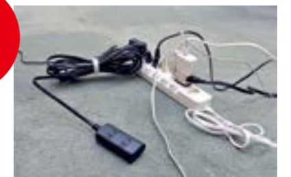
たこ足配線ときつく束ねた電源コード
