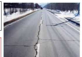
凍上災害による舗装の損傷事例
