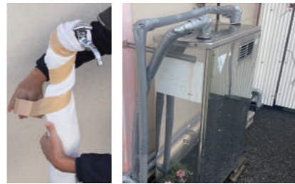
対策されている水道管と給湯器
