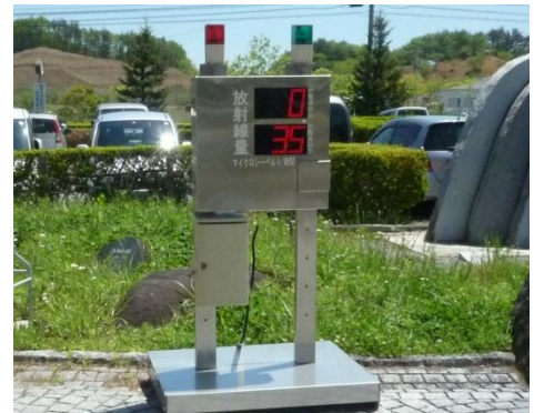
（飯舘村敷地内に設置されたモニタリングポスト）
