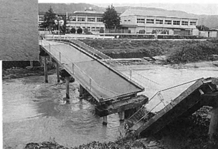
写真1-30 河川の氾濫と道路・橋の破壊状況
