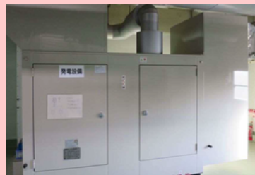
停電時の自家発電設備
