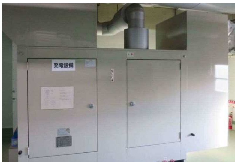
非常用自家発電設備
