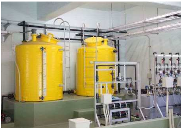
浄水処理設備（塩素消毒）
